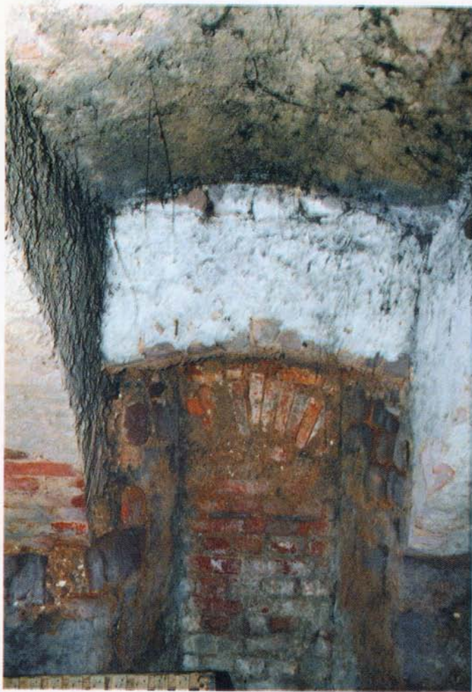
Schüröffnung zum Brennofen der ehemaligen Ziegelei Christian Seewald, Merchweiler. Nach Umbau wurde die Öffnung zugemauert.
